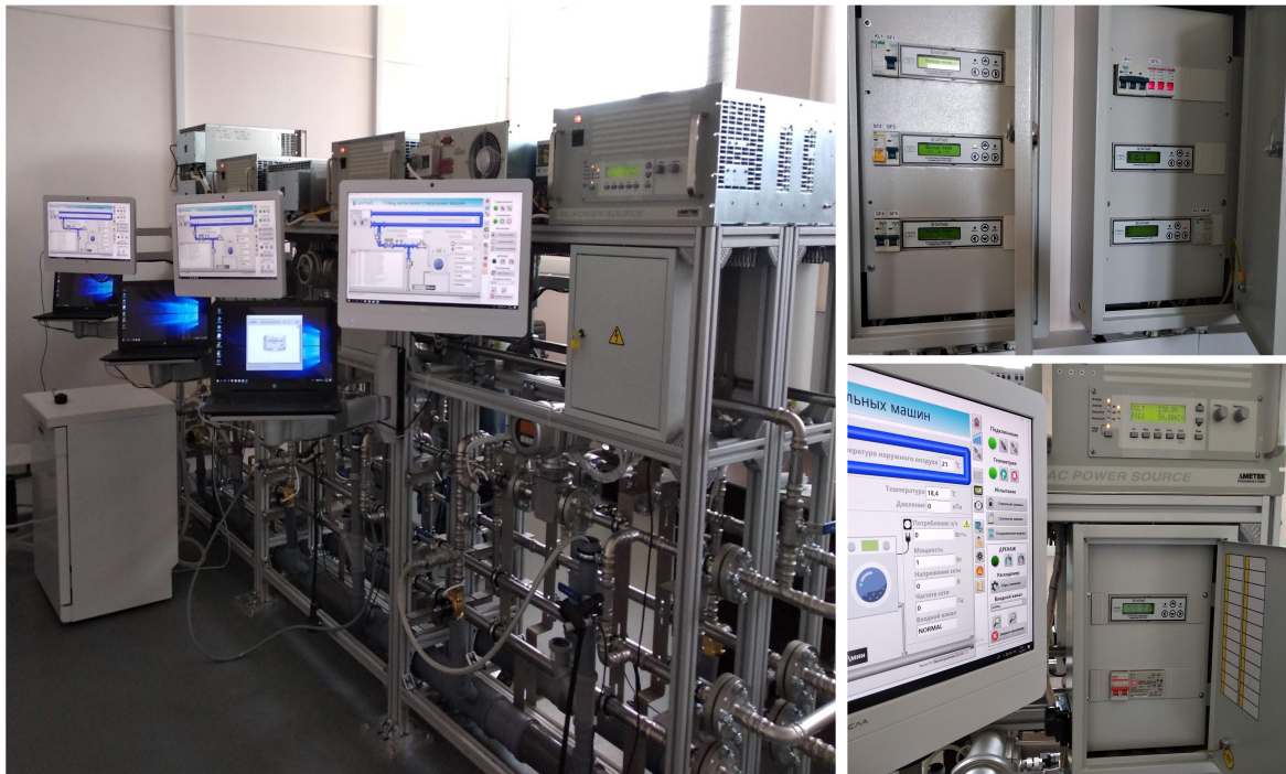
Станция водоподготовки и тестирования стиральных машин "БЕЛГИСС"
